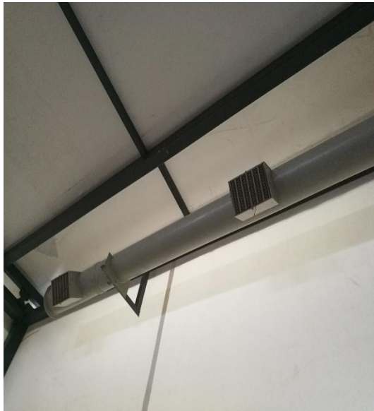
废气收集设施
