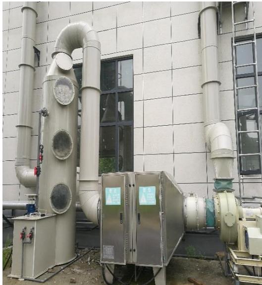
离子除臭设施
