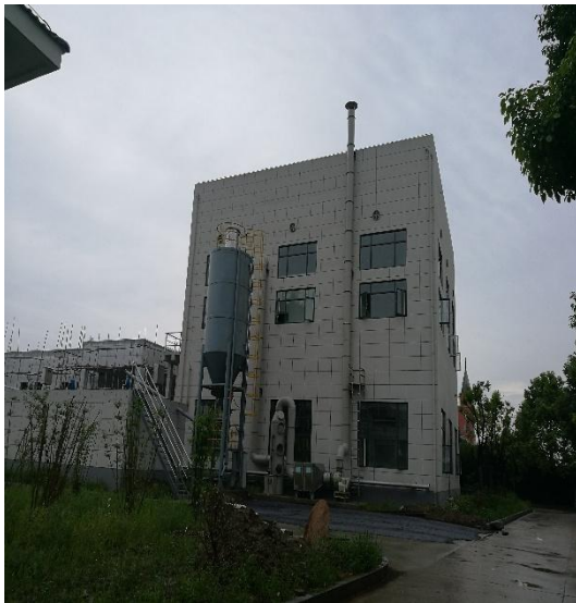
离子除臭设施及 15m 高排气筒
