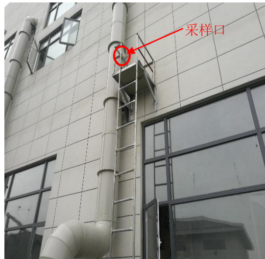
废气采样口及采样平台
